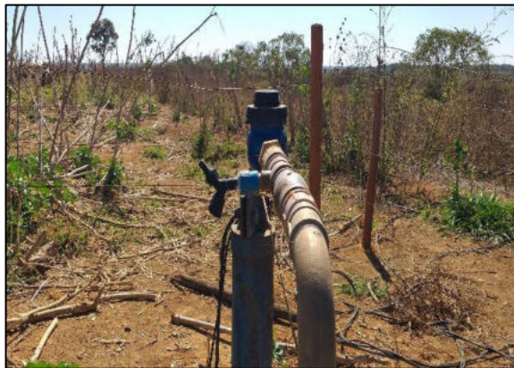
Figura 5. Poço tubular outorgado na Fazenda Guará.
