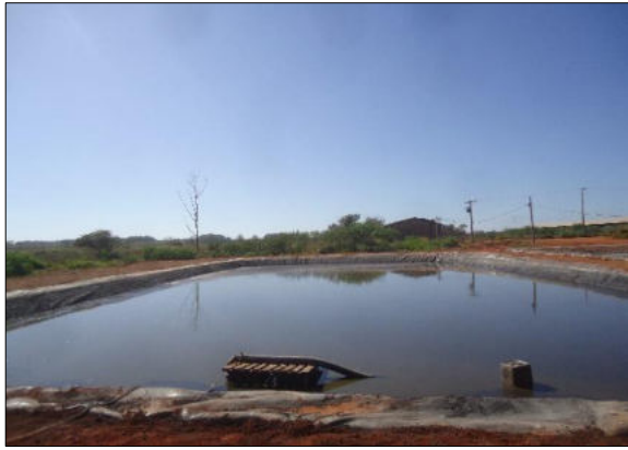
Figura 20. Lagoa 1 do sistema de tratamento de dejetos.
