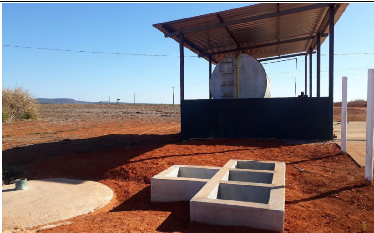
Figura 33. CSAO do posto de combustível da Fazenda Guará.
