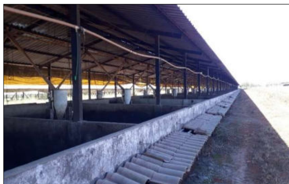
Figura 15. Vista das canaletas da granja na Fazenda Guará.
