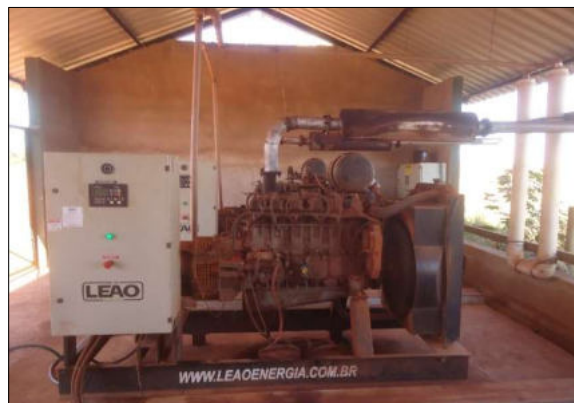
Figura 27. Gerador de energia a partir do biogás presente na Fazenda Guará.
