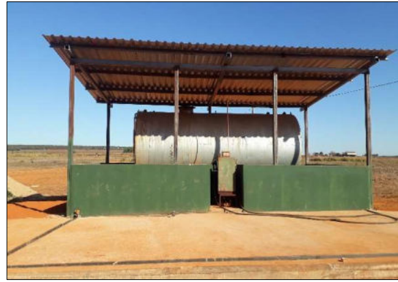
Foto 8 - Armazenamento de combustível.
