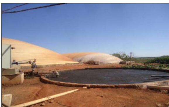
Figura 16. Equalizador do sistema de tratamento de dejetos da granja.
