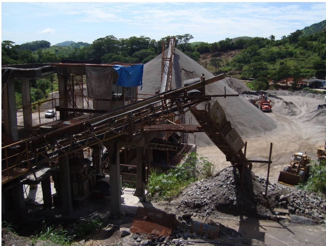
Figura 12. Instalação de beneficiamento
