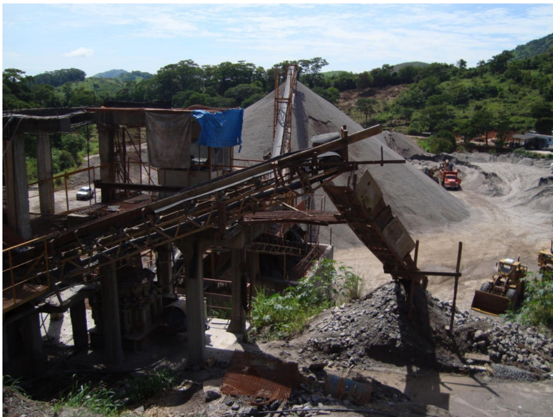
Figura 10. Instalação de beneficiamento
