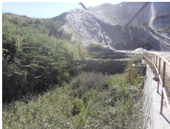
Figura 85. Bacia de contenção principal
