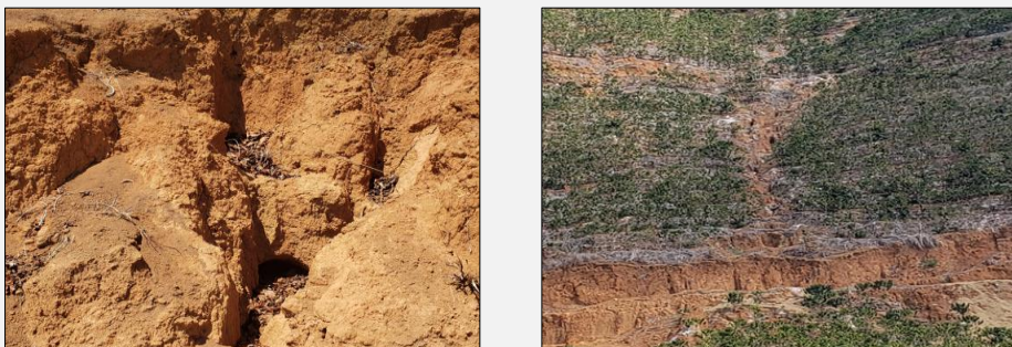
Figura 46. Processo erosivo na seção inferior do aproveitamento presentes na ADA.
